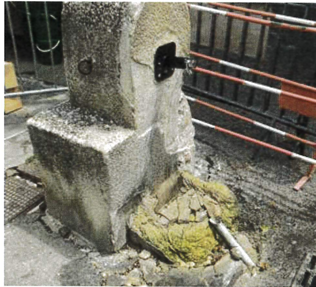
Petite fontaine mal placée a été endommagée par un camion.
